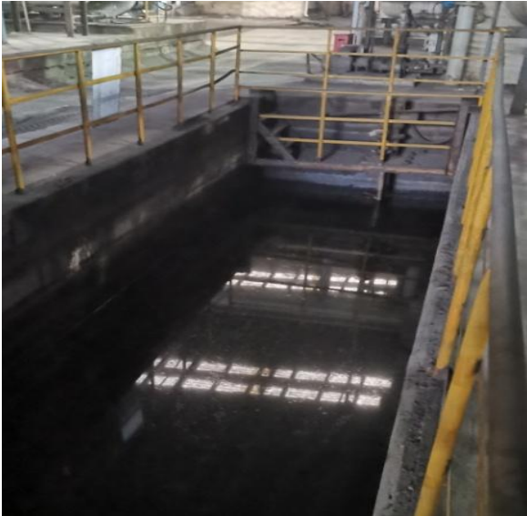
固溶车间事故应急池 1
