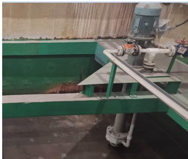
黑卷酸洗车间事故池应急泵切换阀
