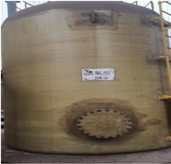
冷轧车间混酸事故收集罐
