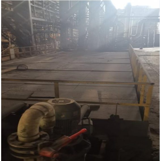
固溶车间事故应急池 2（加盖）
