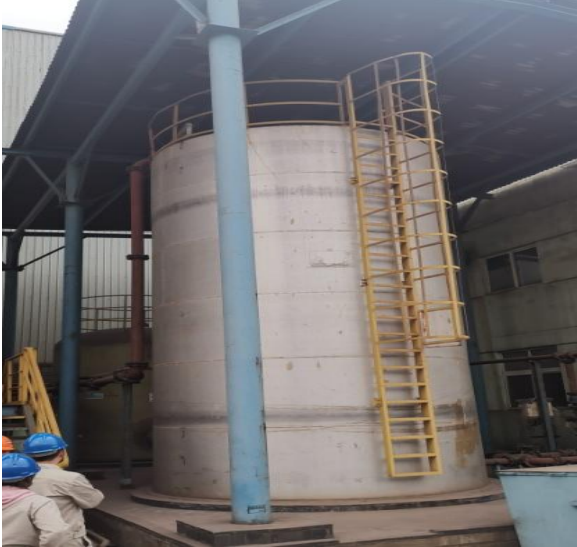
冷轧车间混酸事故收集罐
