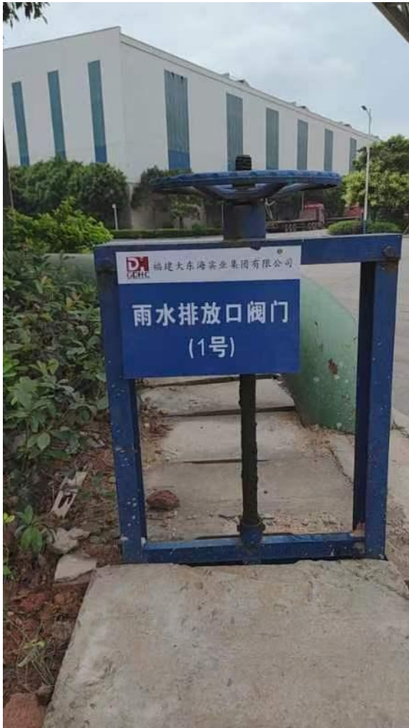
雨水排放口阀门（1号）
