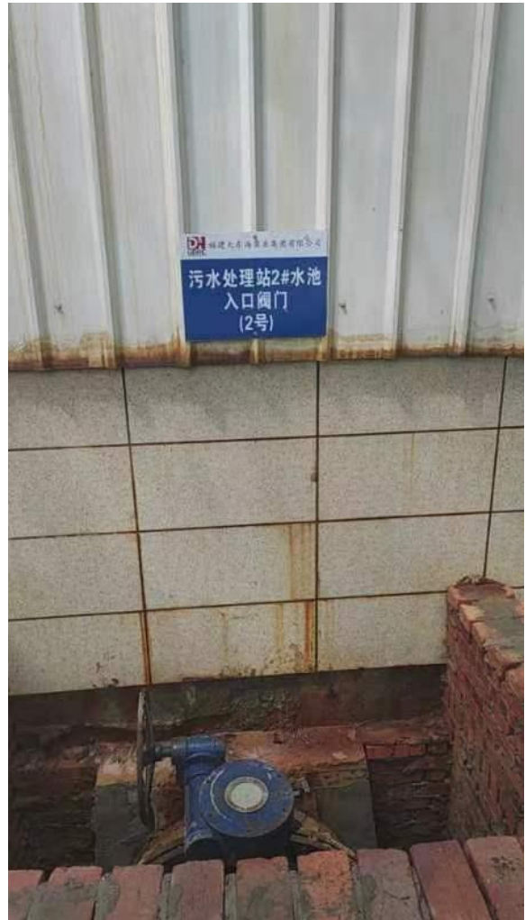
污水处理站 2#水池入口阀门（2号）
