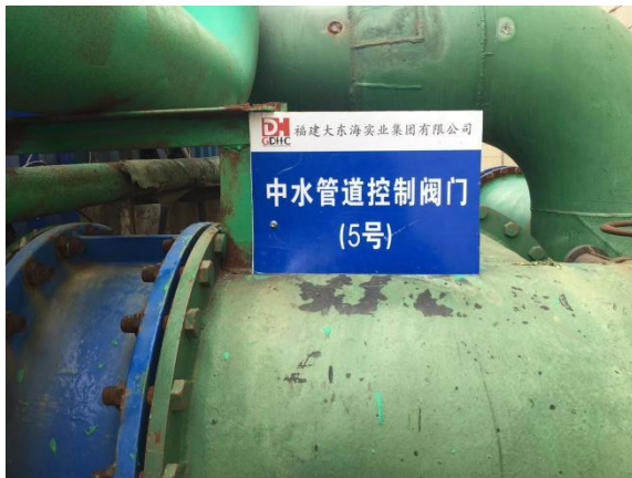
中水管道控制阀门（5号）
