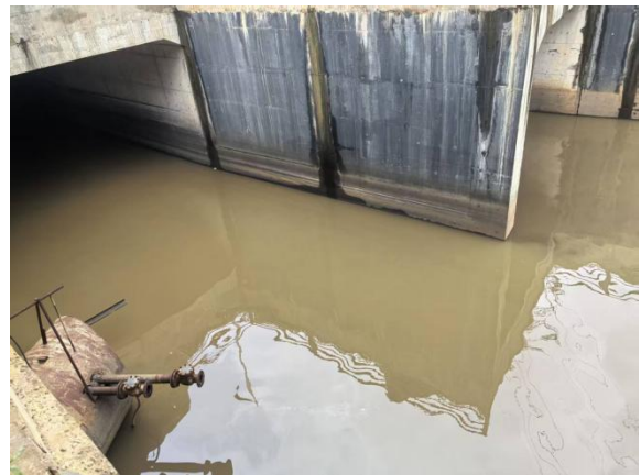
全厂雨水排放口
