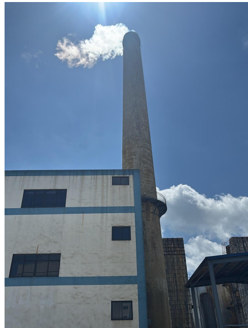
三四期热媒炉废气排气筒
