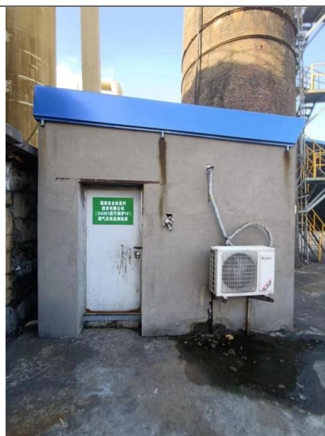
锅炉废气在线监测设备
