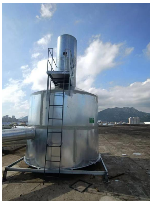
三期纺丝废气排气筒
