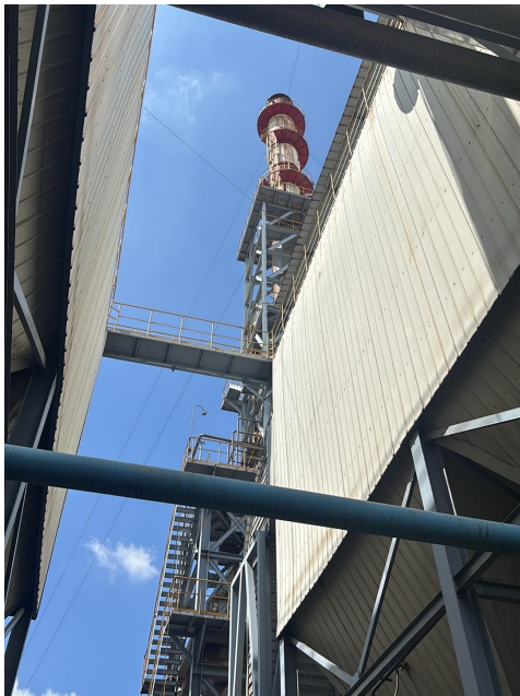
一二期热媒炉废气排气筒
