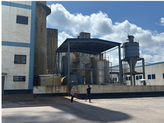
碱液、氨水储罐
