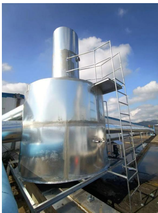
三期加弹废气排气筒
