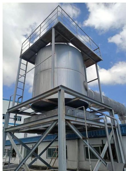
四期热定型废气排气筒
