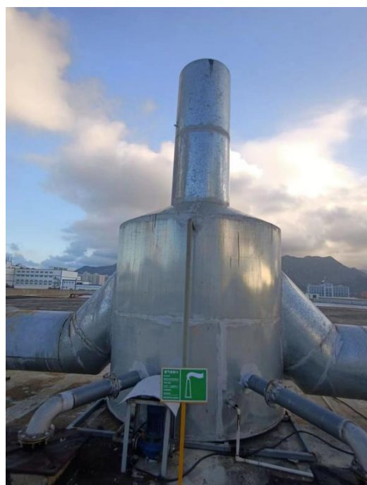
二期加弹废气排气筒
