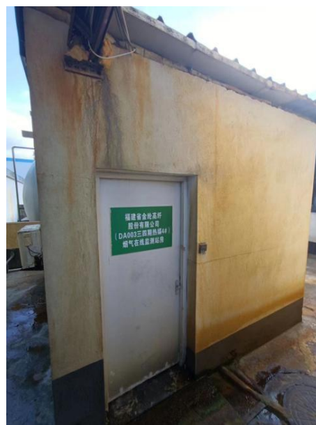
三四期热媒炉废气在线监测设备
