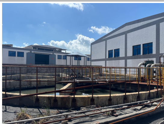
脱硫除尘废水处理设施
