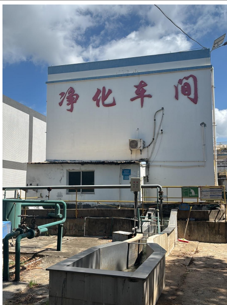
废水规范化排放口
