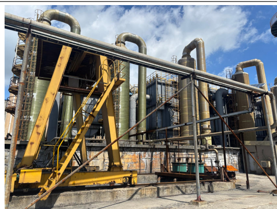
布袋除尘+钠碱法脱硫装置
