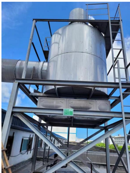
一期热定型废气排气筒
