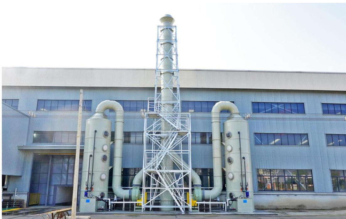
图 8.2-1 前处理封闭间碱液喷淋塔实物图
